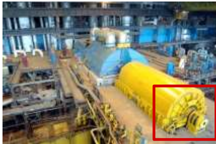
Cuscinetti con olio lubrificante In pressione
