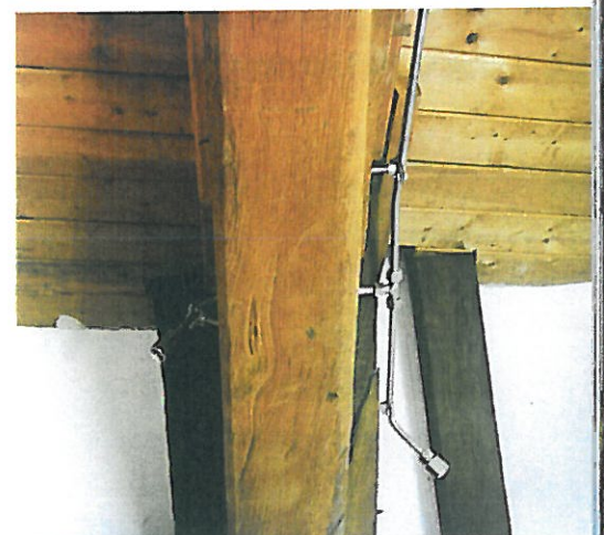
Eine Wassernebellöschanlage schützt das Museum im Schloss Moers. →
