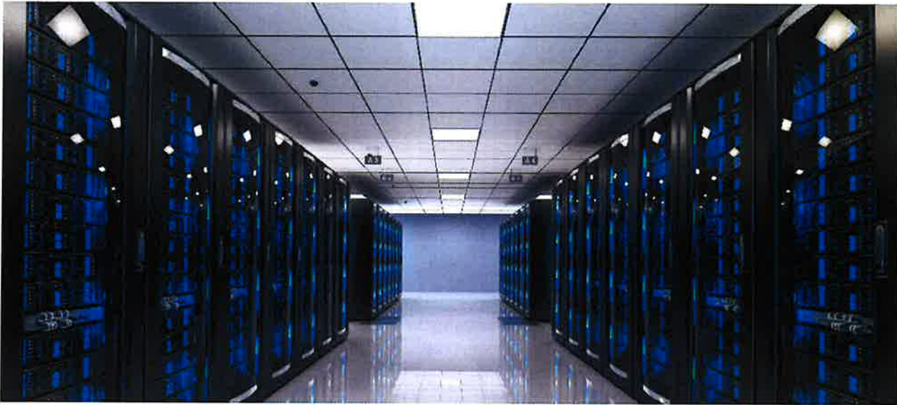
Bild 5 Serverbereiche im Rechenzentrum Foto: FOGTEC
